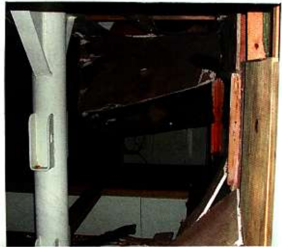
Overal hangen platen met asbest.
